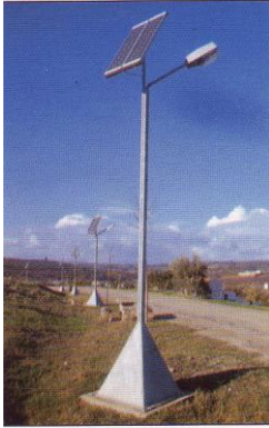
Fig. 12. Energía solar para el alumbrado.
